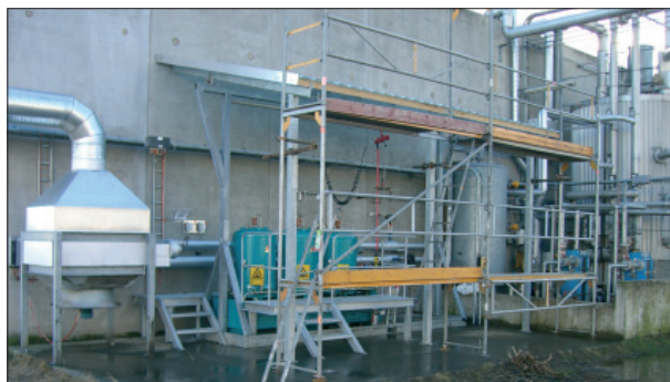
CJC™ Finfilter installeret ved Koppers Denmark A/S
